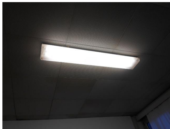
Figura 4.19 - Particolare dei corpi illuminanti ubicati in un corridoio
