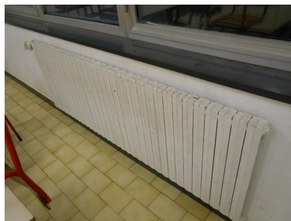
Figura 4.8 - Particolare di un radiatore in ghisa
