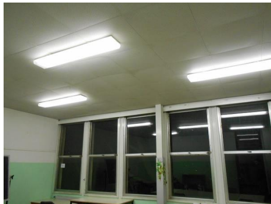
Figura 8.10 - Particolare di una plafoniera a tubi fluorescenti
