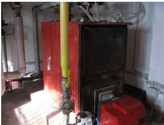
Figura 4.14 - Particolare delle caldaie
