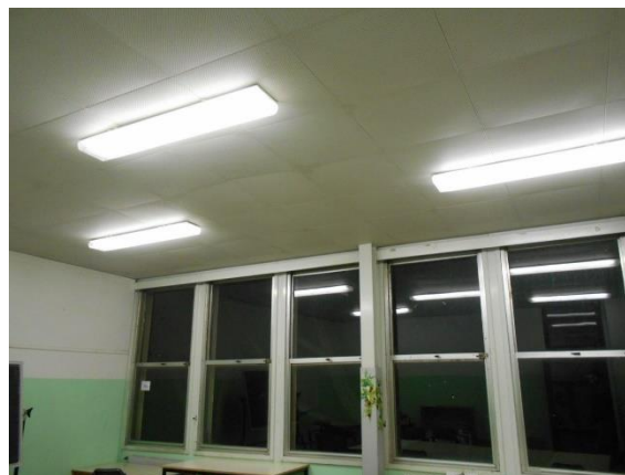
Figura 4.17 - Particolare dei corpi illuminanti ubicati nelle aule scolastiche
